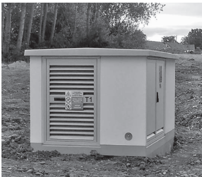
Pohled na trafostanici ze silnice vedoucí do staré části Nové Vsi.
