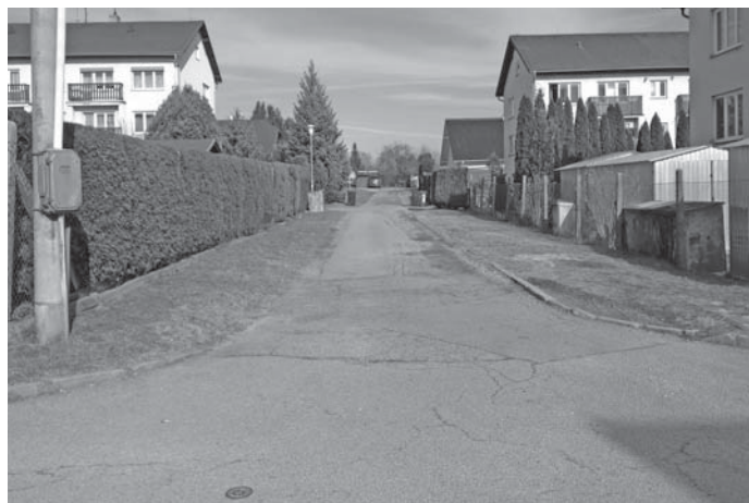
Aktuální neradostný stav u bytovek.
